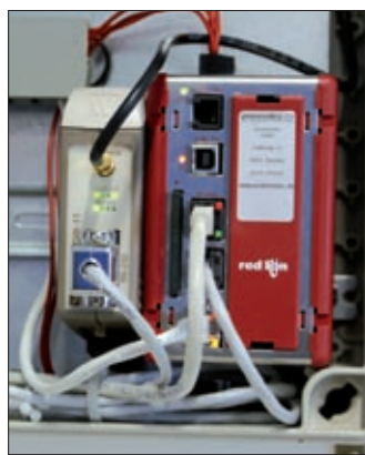
Normalerweise in den Zwischendecken – hier ausnahmsweise sichtbar an der Wand montiert: Seneca-Module, die die Messwerte der Sensoren auf den Datenbus geben.
