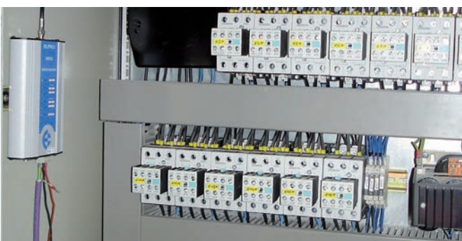
Funktmodem E805E-U im Schaltschrank der Zentralsteuerung
