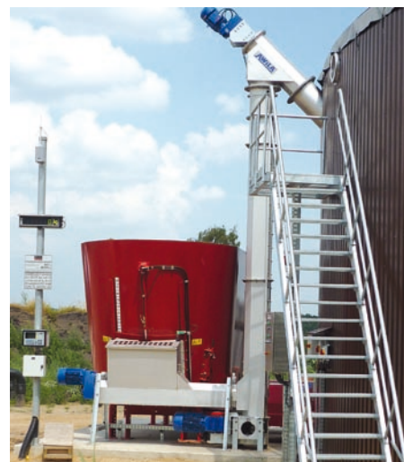
In diesem Behälter werden die Feststoffe, etwa Maissilage, gesammelt und durchmischt, bevor sie in den Fermenter gefördert werden
