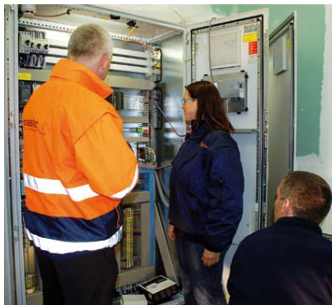
Bei der Inbetriebnahme herrscht Gedränge im kleinen Technikraum der Biogasanlage. Im Schaltschrank sorgt eine SPS von Siemens für die Steuerung der gesamten Technik – direkt an sie angebunden ist das Fernwirkmodul eWON aus dem Hause Wachendorff.
